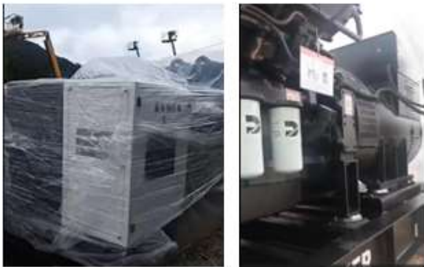
Planta Nueva 1.000 kW en Zona Franca Bogotá
