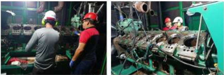
Unidad 9 en Mantenimiento
