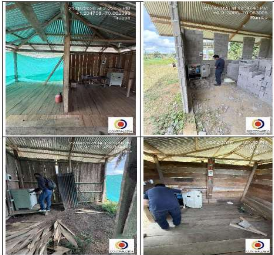
Imagen No. 19 Instalación de sistemas en predios sin ocupación real o sin uso residencial
