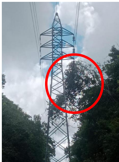
Torre 106 Línea 34,5 kV
