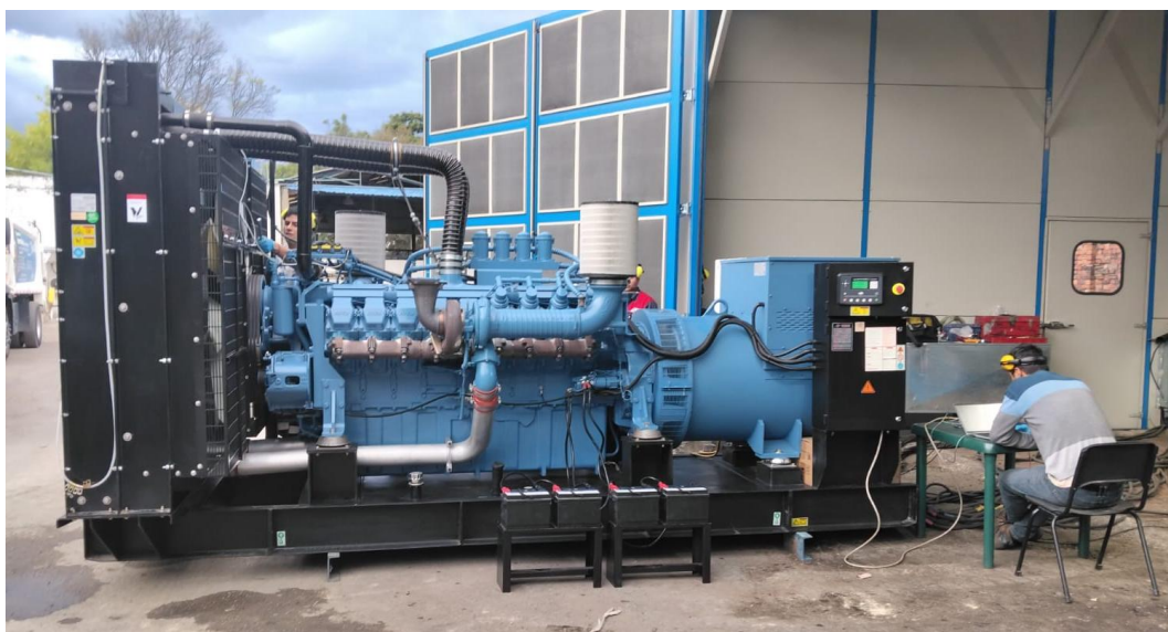
Nueva planta de generación de Mitú en pruebas
