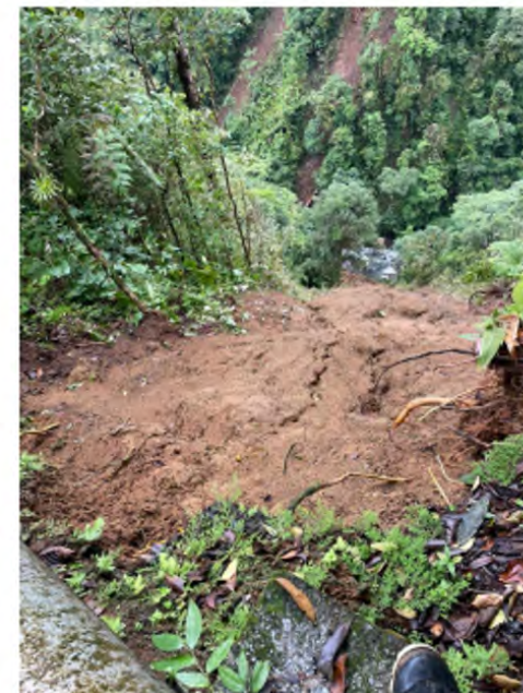
Estudio geotécnico para estabilización del talud que soporta el anclaje 65 de la tubería de carga en la PCH Mutatá.
