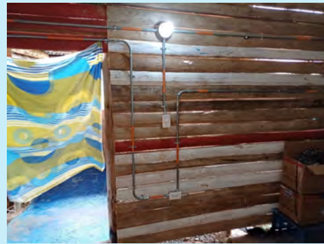
Redes eléctricas internas en vivienda de la vereda La Cristalina del municipio de Dagua (Valle)
