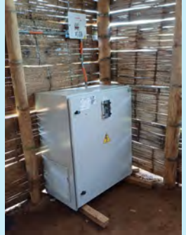
Gabinete de equipos en vivienda de la vereda La Cristalina del municipio de Dagua (Valle).
