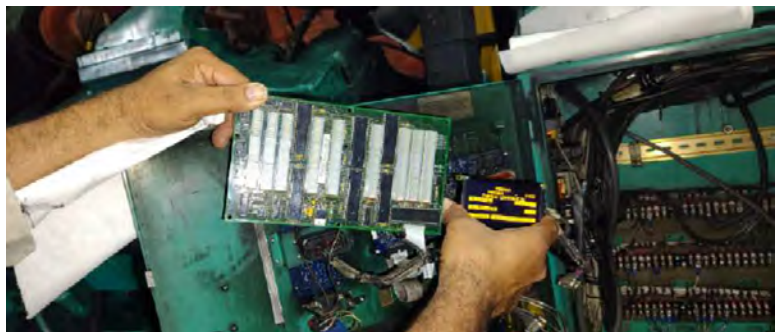
Display en funcionamiento.
