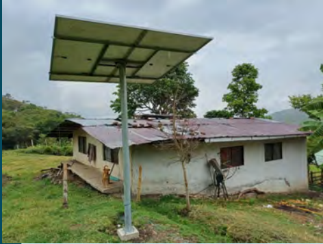
Sistema individual solar fotovoltaico en la vereda Potrerito de Pradera (Valle).
