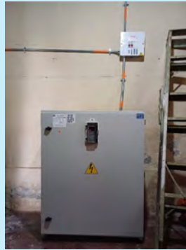
Gabinete de equipos en vivienda de la vereda Potrerito del municipio de Pradera (Valle).
