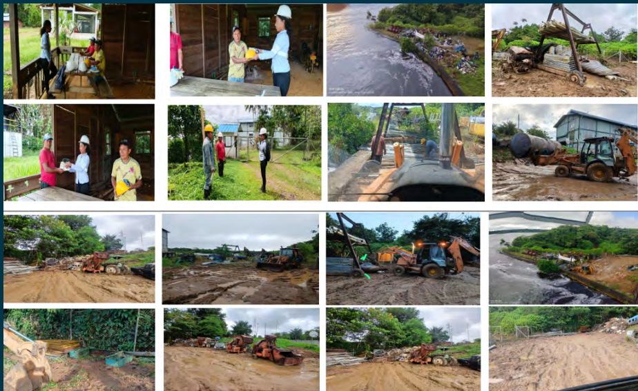
Movimiento de elementos inservibles propiedad del MME por incremento de nivel del río en la zona del canal de restitución en la PCH Mitú.
