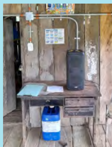
Instalaciones internas en vivienda de la vereda Atausí, municipio de Frontino, departamento de Antioquia.
