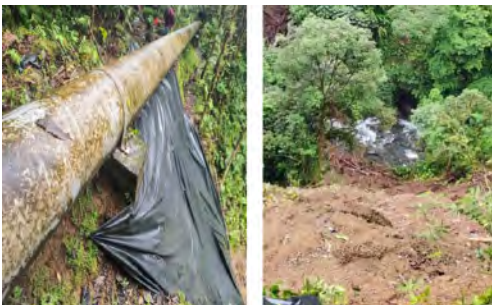
Deslizamiento anclaje 65 tubería de carga PCH Mutatá, Bahía Solano.
