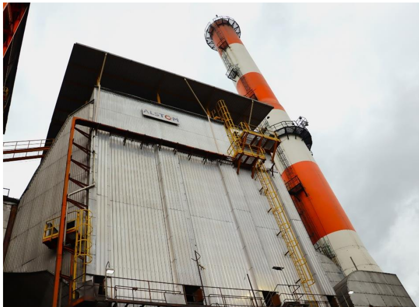
Precipitador electrostático y chimenea Unidad 3 Termopaipa
