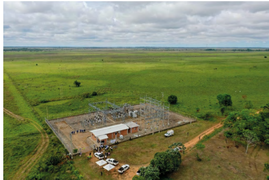
Subestación Santa Rosalía 115 kV, Vichada
