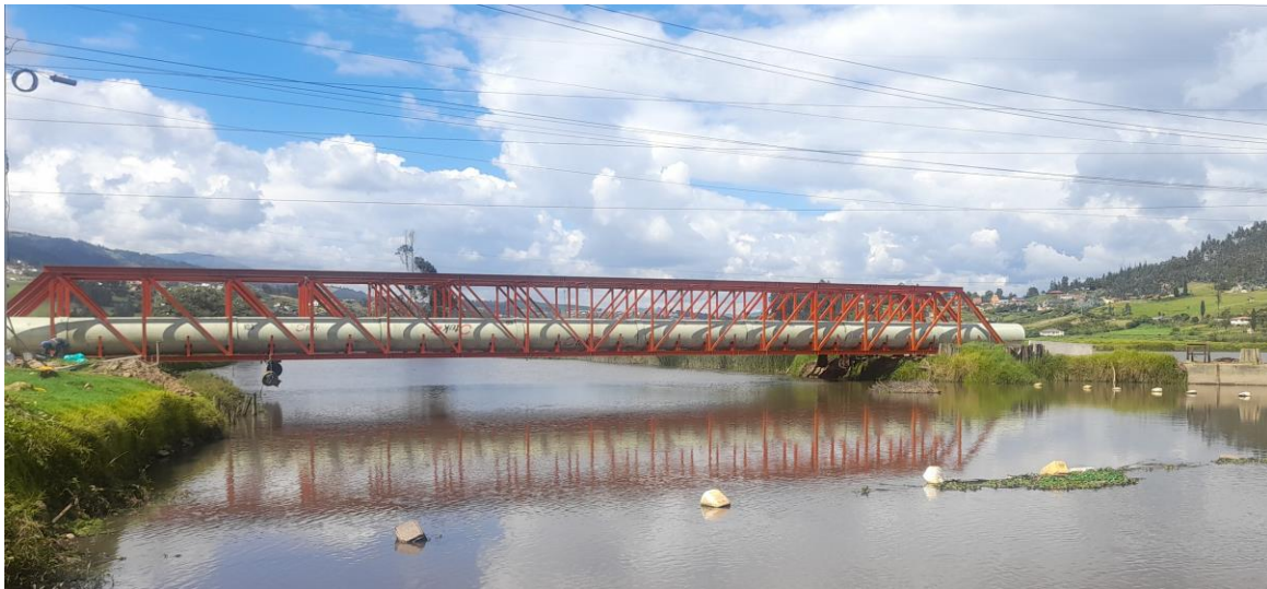
Estructura metálica con tubería instalada en Termopaipa.
