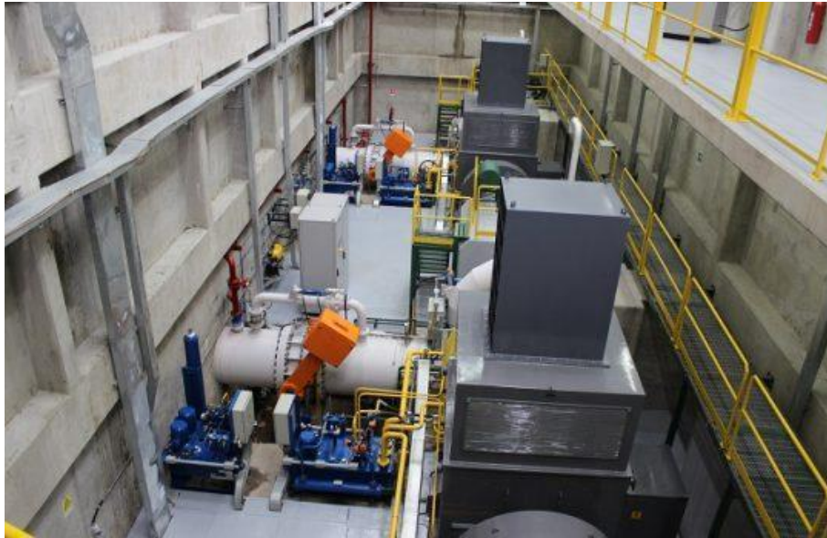
Ilustración 30. Casa de Máquinas, disposición equipos de generación, Fuente: http://www.revistaei.cl/wp-content/uploads/sites/5/2017/05/1.-Instalaciones-de-Mini-Hidro-Pulelfu-copia-540x350.jpg
