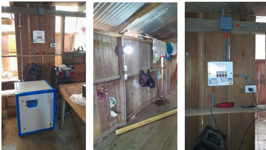
Equipos instalados que les permiten a los beneficiados contar con energía eléctrica.
