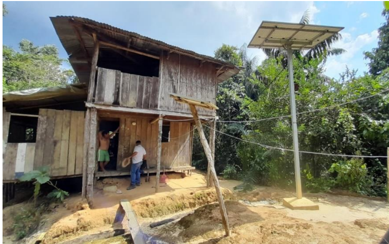
Instalación solar de una de las viviendas beneficiadas.
