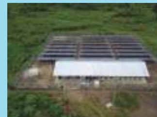
Central de generación fotovoltaica de 109,35 kWp en la localidad de Chorrobocón, Guainía. Usuarios atendidos: 189
