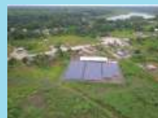
Central de generación fotovoltaica de 182,25kWp en la localidad de Laguna Colorada, la cual interconecta a la localidad de Pueblo Nuevo, a través de una línea de 3 km a 13,2 kV. Usuarios atendidos en Pueblo Nuevo: 12
