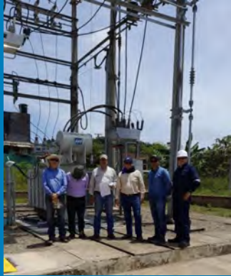
Visita de verificación a la subestación Capricho de Carlos Triana Grajales (Gensa), Ómar Olarte Triana (MME), Leandro Rojas Medina y Jorge Galindo Gómez (CGR) y de Yeisson Suárez Niño (Interventoría).
