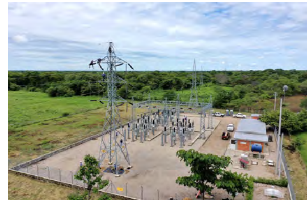
Subestación de La Yopalosa en Nunchía (Casanare)
