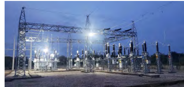
Subestación de 115kV, de San Luis de Palenque (Casanare).
