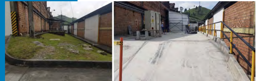
Imágenes externas de la subestación antes y después
