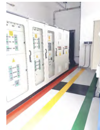
Equipos de la subestación
