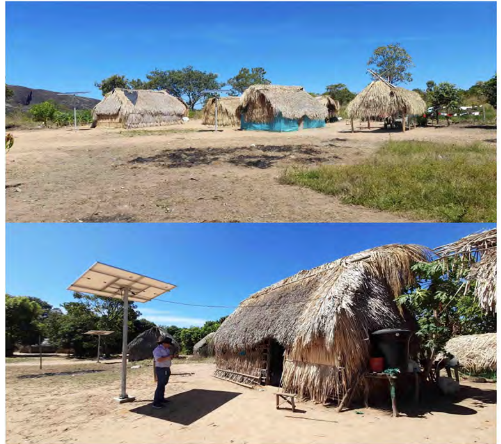
Instalaciones solares fotovoltaicas individuales en la comunidad indígena de San Antonio del municipio de Puerto Carreño (Vichada)
