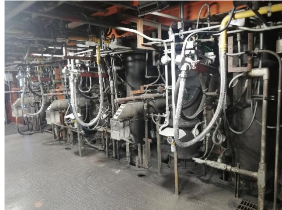
Después - Iluminación quemadores caldera U2
