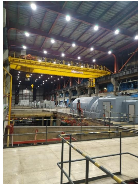
Después - Iluminación turbogeneradores
