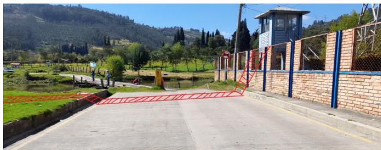
Vía "Puente de tabla" por donde se pasará la tubería de conducción
