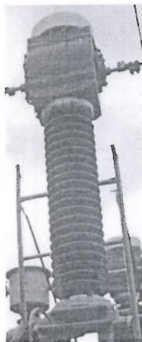
Transformador de Corriente.
