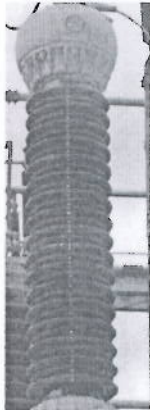
Transformador de Tensión.
