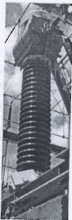
Transformador de Corriente.
