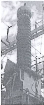
Transformador de Tensión.
