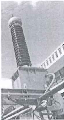
Transformador de Tensión
