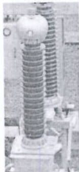
Transformador de Tensión.
