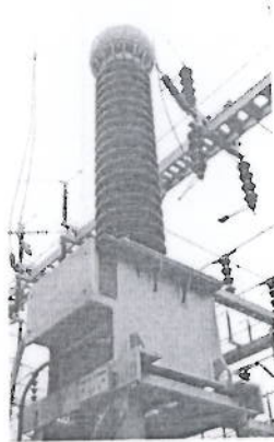
Transformador de Tensión.
