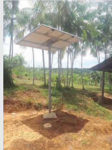
Sistema fotovoltaico en vivienda ubicada en la vereda Bocas del Querarí del municipio de Mitú (Vaupés).
