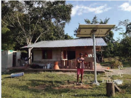
Sistema fotovoltaico en el municipio de Unguía (Chocó).
