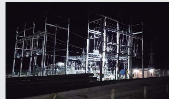
Subestación San Luis de Palenque
